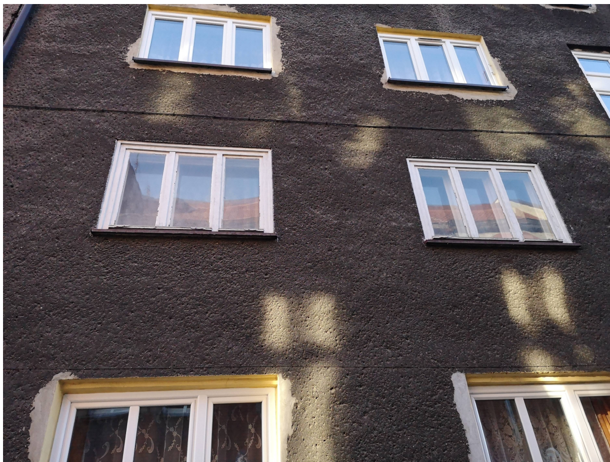
Rys. nr 7-18. Wybrane uszkodzenia dla całego budynku.
