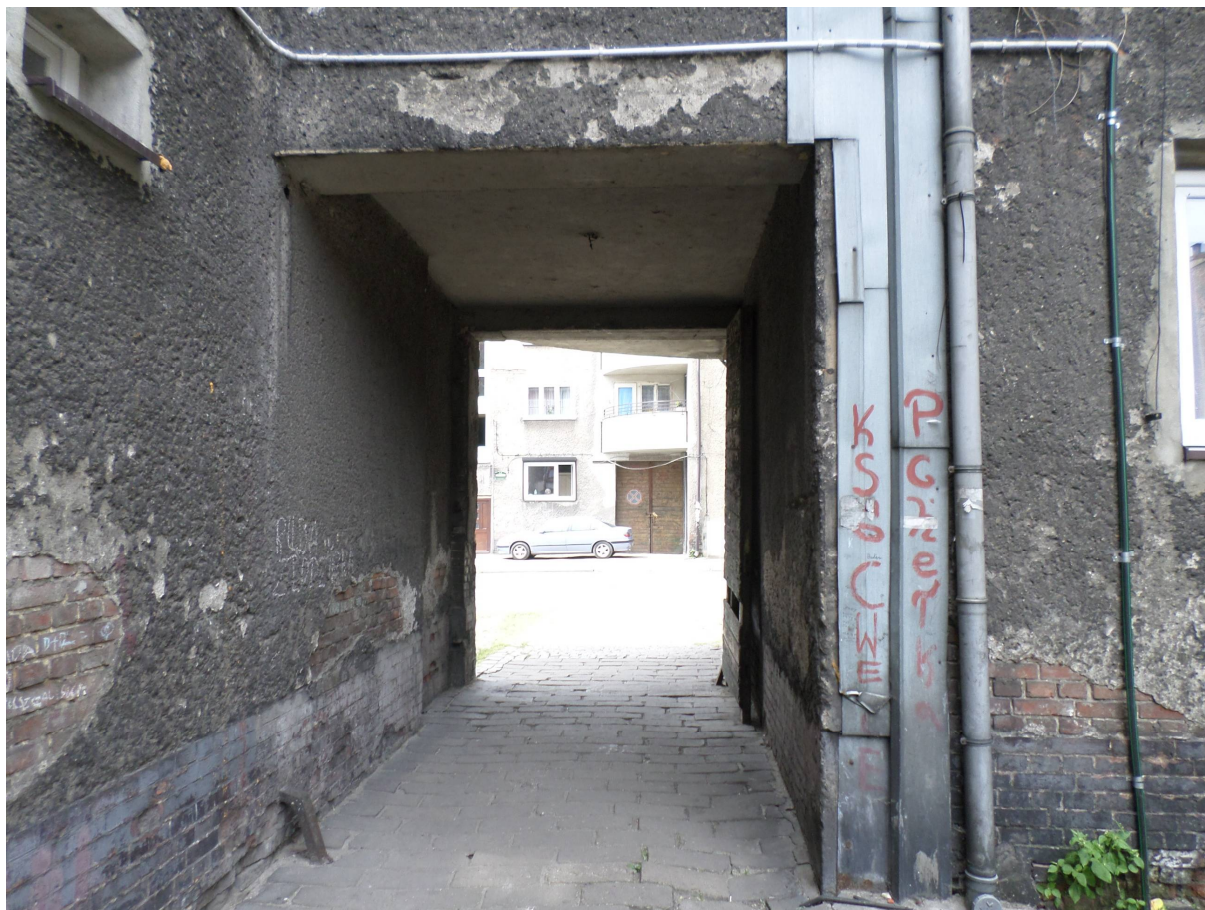
Rys. nr 6-29. Wybrane uszkodzenia dla całego budynku.
